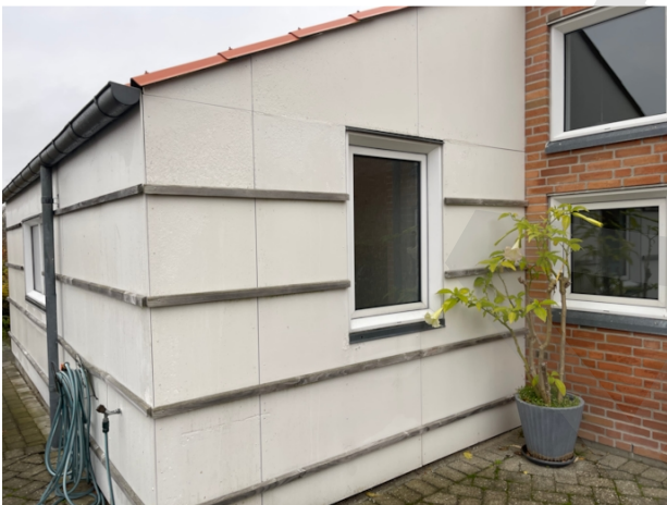
Pladebeklædning med forvittringer
