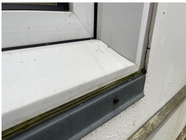
Defekte fuger ved vinduer
