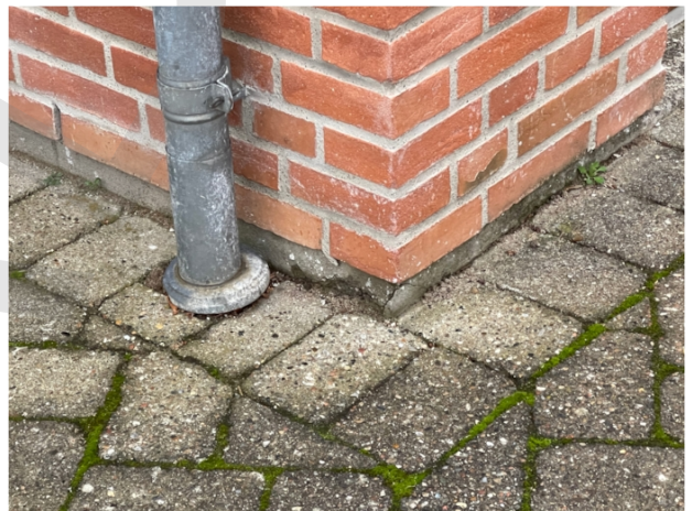
Revner og afskalninger i sokkelpuds
