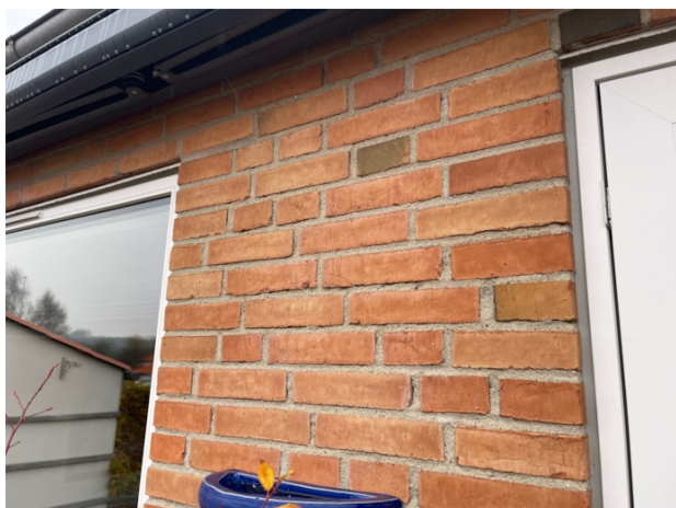
Porøse fuger i murværk
